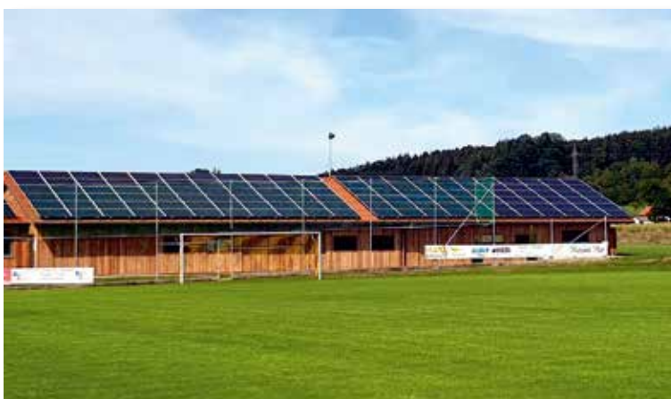
Vorbildliche PV-Anlage am Sportplatz in Ramsau
